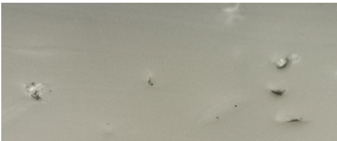
Figur 4:13 Närbild på deformationer, dock ej helt genomgående hål, i underliggande förstärkningsplast av fabrikat PE-LD Strongtäck (Foto: Göran Berggren).
