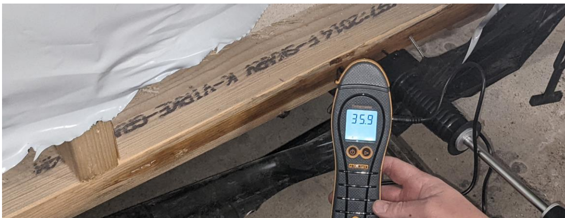
Figur 4:22 Exempel på fuktskadad syll där fukten trängt in genom ett spikhål från infästningen av läkt som sträcker emballaget. Notera fuktskadans utbredning och att syllen är mättad kring inläckagepunkten (Foto: Göran Berggren).
