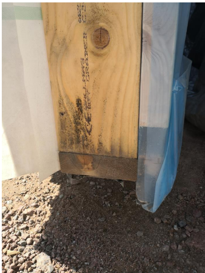
Figur 4:26 Exempel på skada orsakad av smuts och vatten som stänkt upp på syll och reglar på ett prefabricerat planelement vid kraftigt regn (Foto S. Olof Mundt-Petersen).
